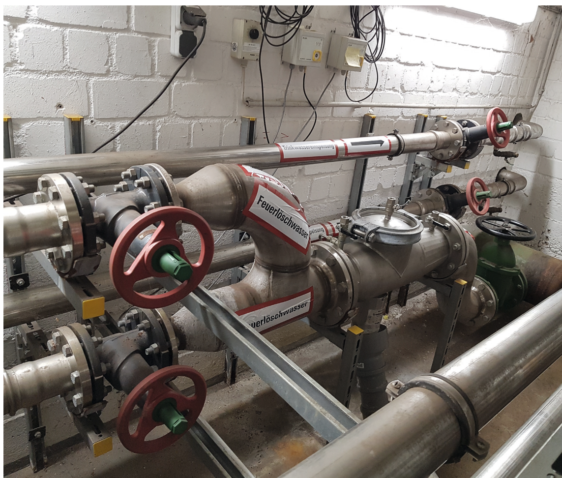
Löschwasseranlage im Bestand mit unzureichender Absicherung
